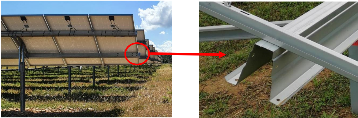
Figure 11 : Présentation de l'architecture de l'installation photovoltaïque à l'extrémité d'une rangée de modules
